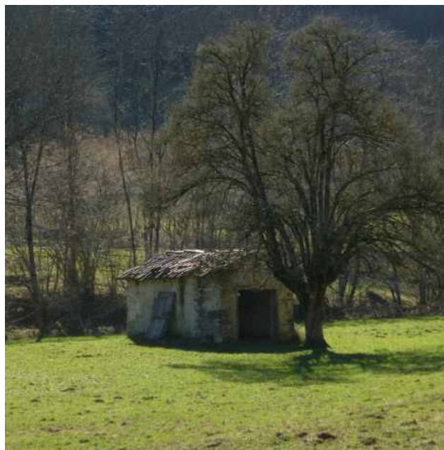
Grange en manque d'entretien à Ferrère
